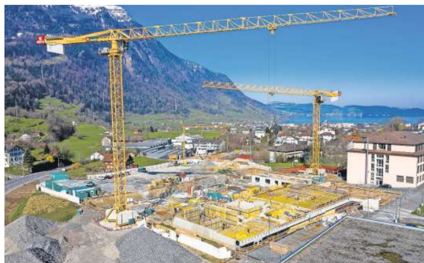
Die Arbeiten für die Lüftungsanlage in der Schul- und Sportanlage Oberarth konnten bereits neu vergeben werden. Bild: Erhard Gick
