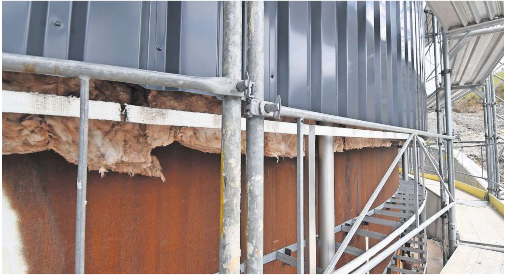
Der Turm in Küsnacht ist bereits verkleidet. Gut sichtbar sind der nackte, rostige Stahl, die Isolation und die Farbe. Genau so wird auch der Turm der Agro Energie Schwyz AG künftig aussehen. Bild: Andreas Seeholzer
